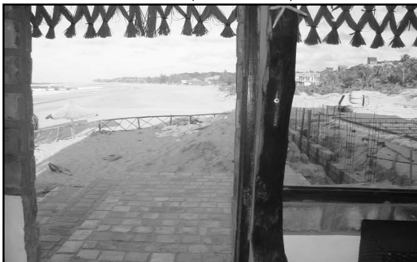
Foto 3 – Construção de piscina e beach bar na orla marítima (Praia da Barra).
